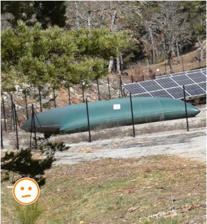
▲ Une implantation de citerne inadaptée
