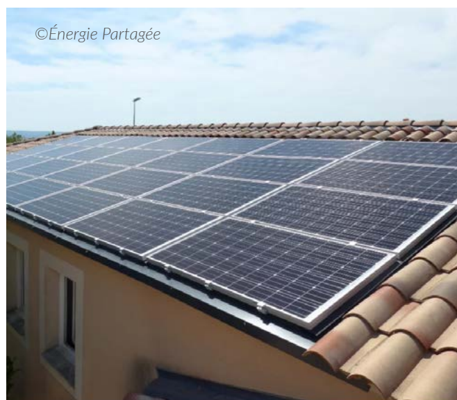
Installation PV sur la toiture du centre technique de Pertuis, avec les centrales villageoises du Pays d'Aigues
