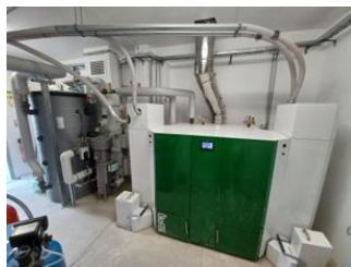
Passage du fioul+gaz à la biomasse
