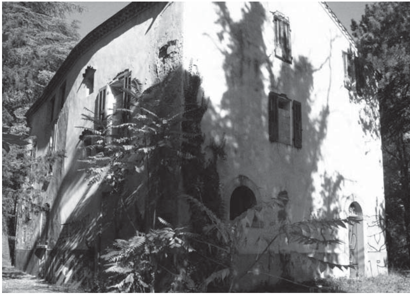
Fig. 1 : le Château de Pélacier ; façades Sud et Est avant les travaux. Photo: GCP - E. Cosson
