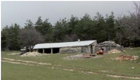
Restauration de la toiture du jas et récupération de l'eau de pluie pour l'abreuvement du troupeau.
