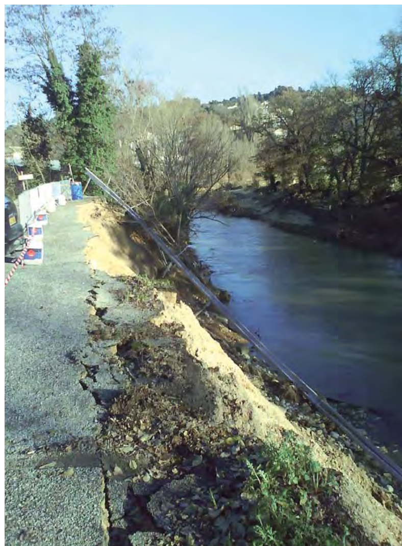
Érosion de berges à proximité d'un parking
