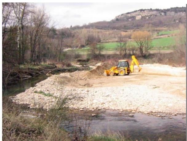
Photo 51 : Extraction de matériaux alluvionnaires, St Martin de Castillon – PNRL, J. BRICHARD
