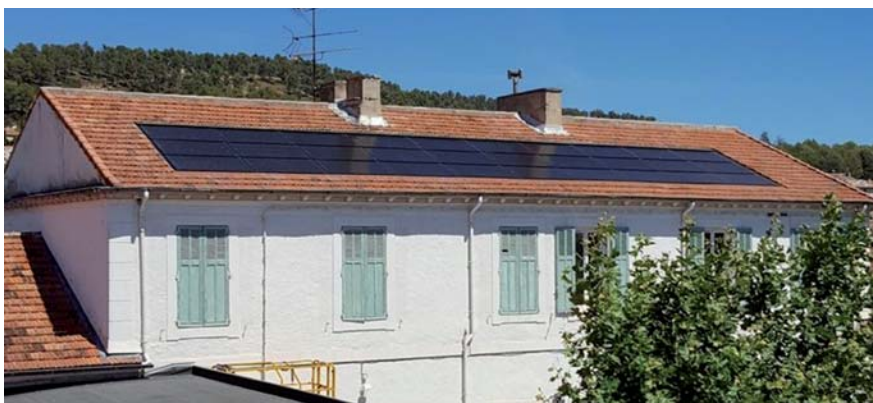
Panneaux installés sur l'école de Villelaure par les Centrales villageoises du Pays d'Aigues
