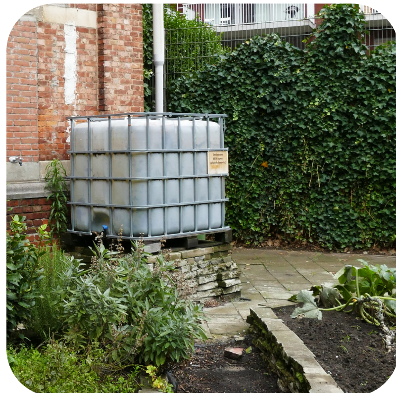
Un réservoir de récupération des eaux de pluie pour arroser le potager
