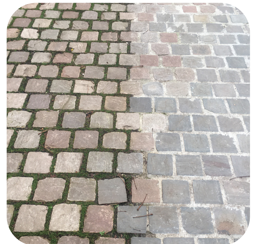
Pavés enherbés : laissent l'eau s'infiltrer naturellement
