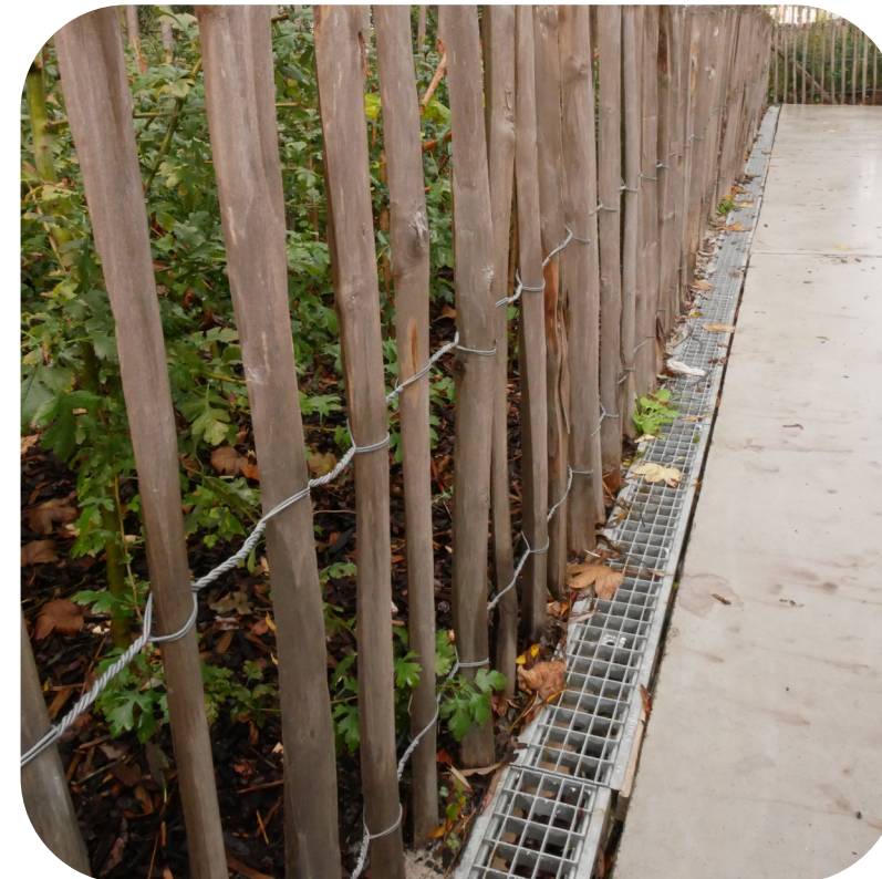
Une bordure qui infiltre l'eau ruisselante
